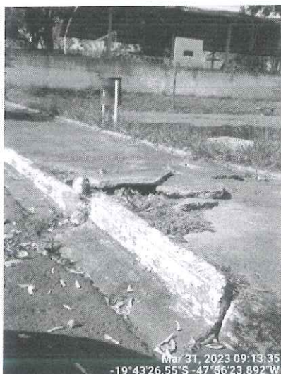
Calçada a ser reparada.
